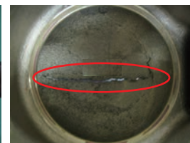
メーターケースの破損【内部】
